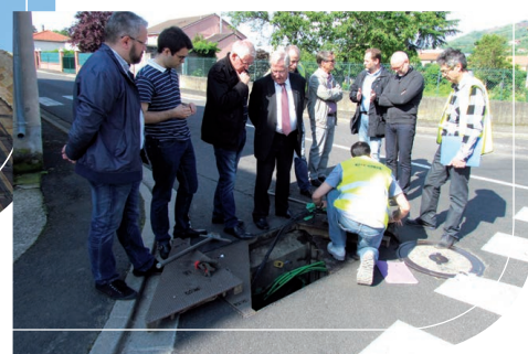
Réception de la fibre optique à Longues : les travaux de construction du réseau sont terminés ; Longues est aujourd'hui entièrement couvert par la fibre. Raccordement possible à partir de l'automne 2016
